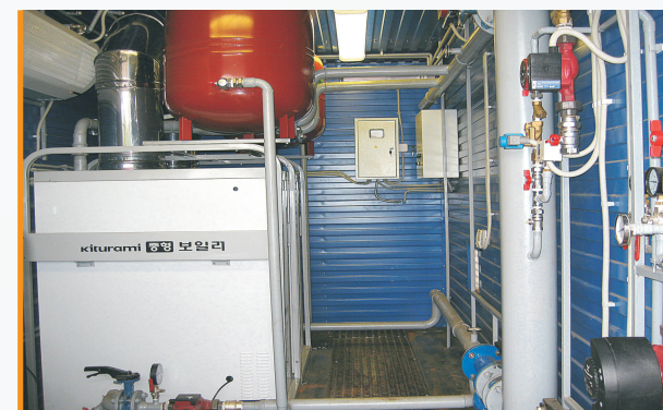
Модульная котельная на 240 кВт ЗАО «Полус»
