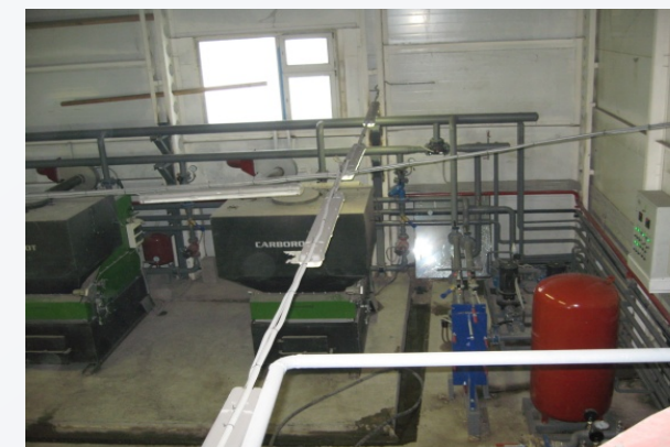
Угольная водогрейная котельная мощностью 0,9 Гкал/ч ООО «Агат»
